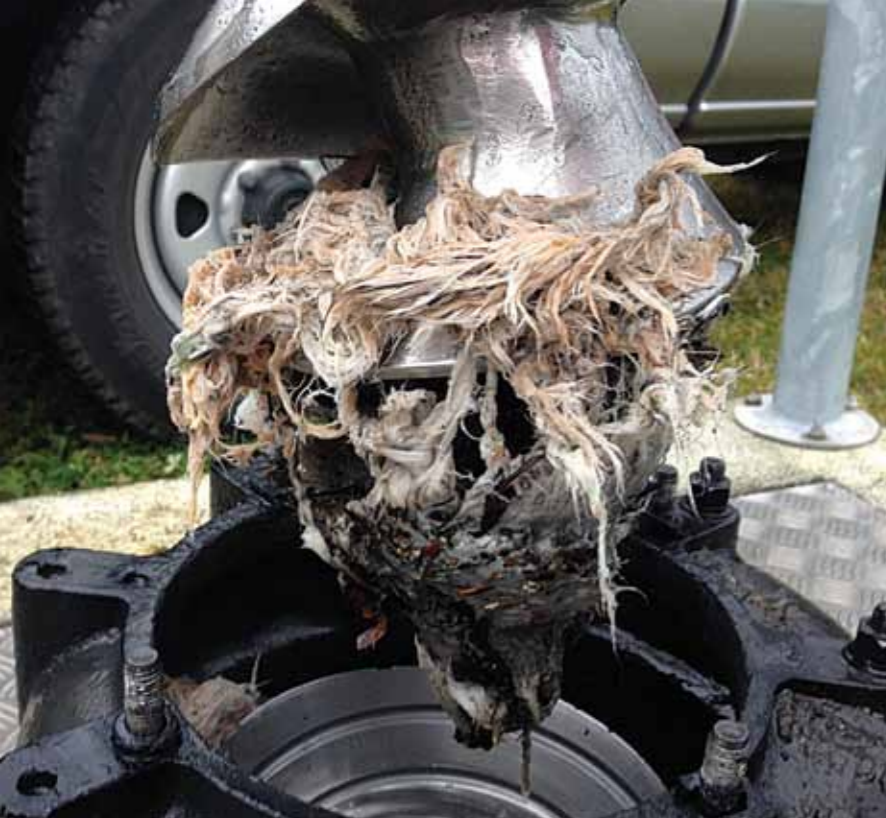
Verstopfte Pumpen, aufwändige Instandstellung.
