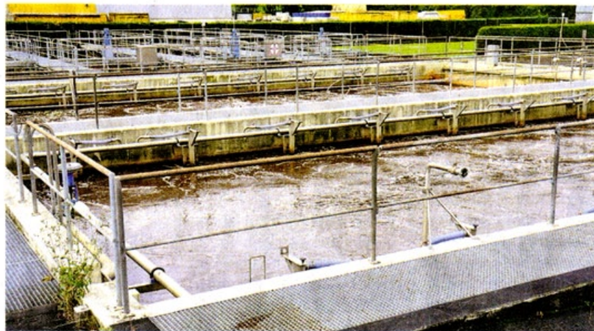
In der ARA Einsiedeln werden die Abwässer der Haushalte und der Industriebetriebe des Bezirks Einsiedeln (ohne Bannau und Euthal) und der Gemeinde Alpthal gereinigt. Die ARA Einsiedeln soll bis zum Jahr 2030 aufgehoben werden. Bild: PD
