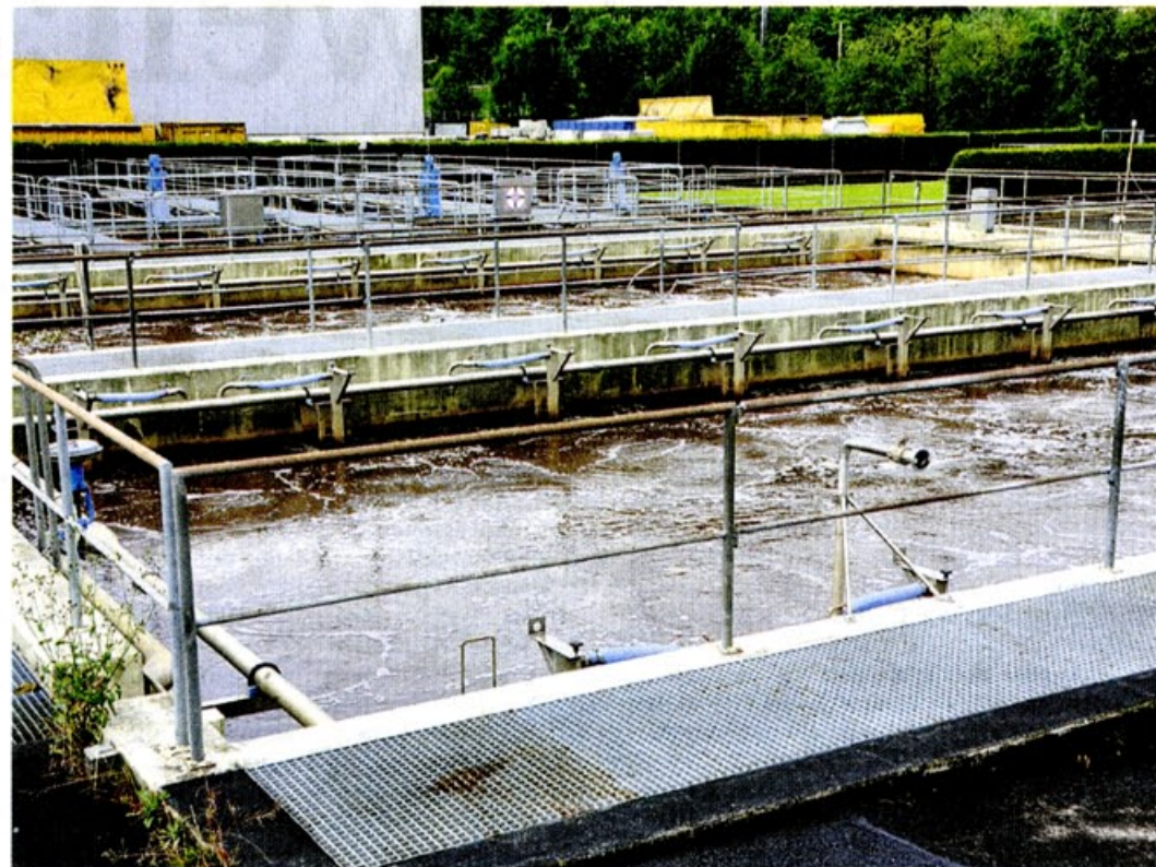
In der ARA Einsiedeln werden die Abwässer der Haushalte und der Industriebetriebe des Bezirks Einsiedeln (ohne Bennau und Euthal) und der Gemeinde Alpthal gereinigt. Die ARA Einsiedeln soll bis zum Jahr 2030 aufgehoben werden. Foto: zvg
